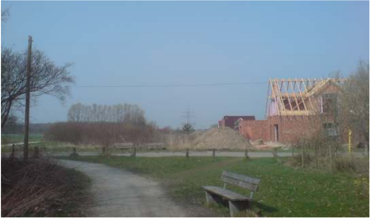
Foto: EK110_2, Blick von Süden, das Erdkabel liegt unter der Grasstreifen neben dem Radweg und weiter nach Norden westlich von den Neubauten, unter den Sandhaufen entlang auf den Abspannmast im Hintergrund zu, der Messweg (a) verläuft auf der Querstraße, der Messweg (b) parallel dazu etwa an der Position des Fotografen
