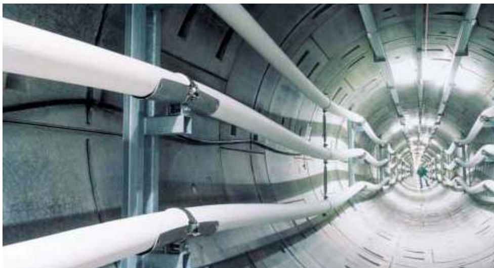
Abbildung 2/7 400 kV-Kabelsystem in einem 6,3 km langen Tunnel im Zentrum von Berlin (Foto: Dellby et al. 2000)
