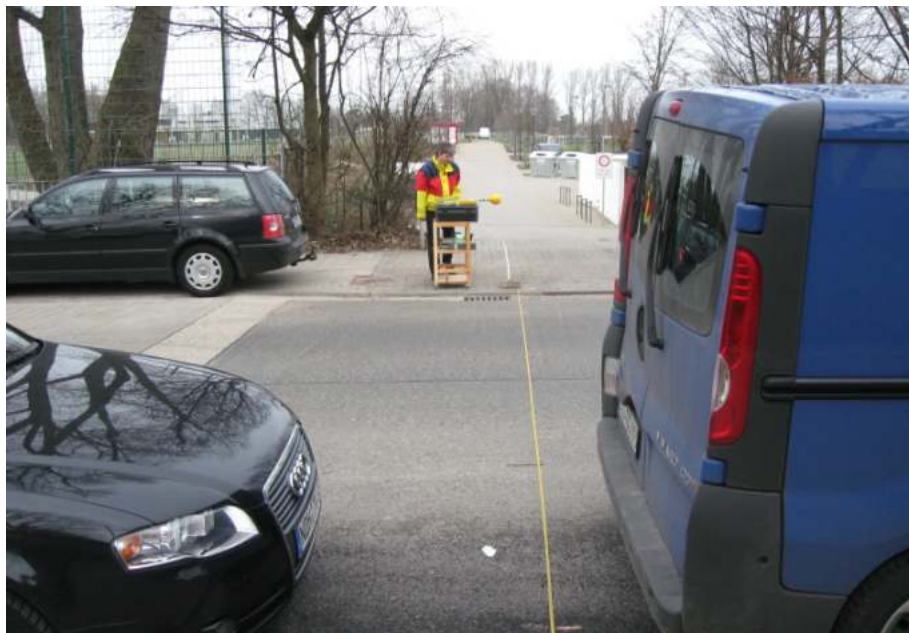
Foto: EK110_5, Blick von Süden, das Erdkabel verläuft unter dem Fußweg, parallel zur Straße
